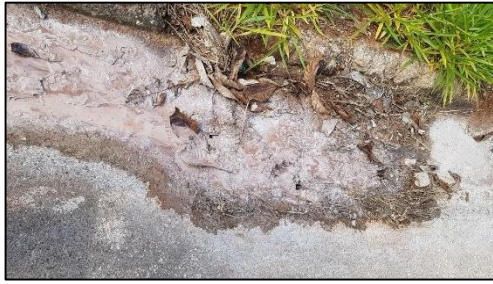
Figura 9 - Boca de Lobo completamente obstruída Fonte: Arquivo Pessoal (2019).
